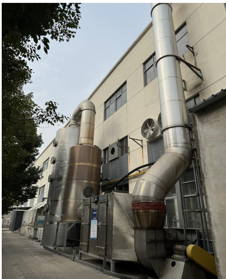
图 3-4 FQ-1#废气处理设施
