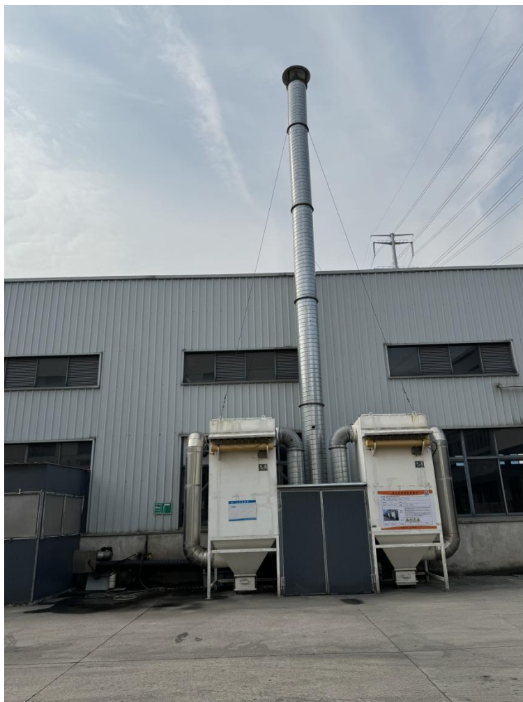
图 3-5 FQ-4#废气处理设备
